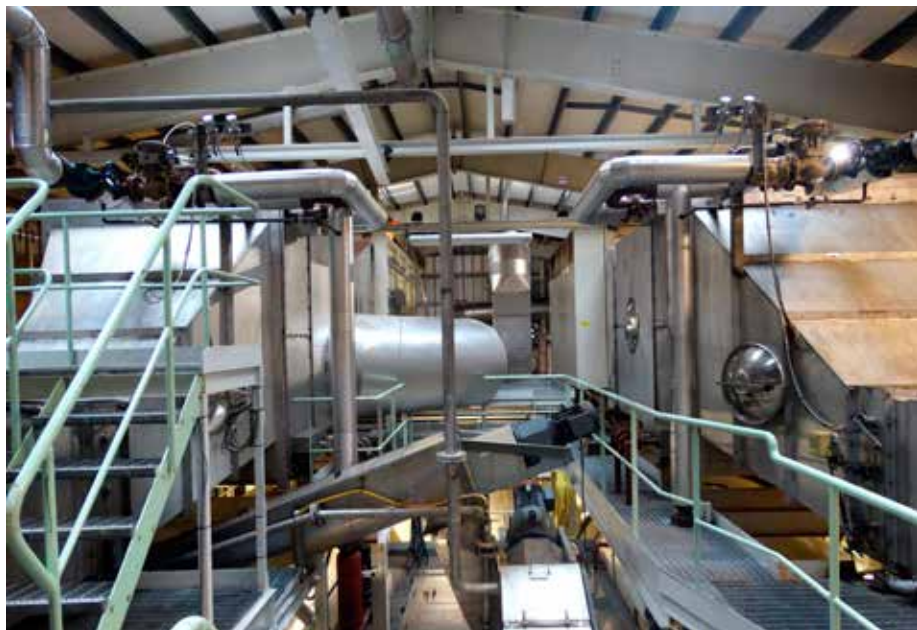
Við rafvæðingu fiskimjölsverksmiðja þarf að koma upp ýmsum búnaði. Á myndinni má sjá búnað við loftþurrkara í fiskimjölsverksmiðju Sildarvinnslunnar í Neskaupstað.
